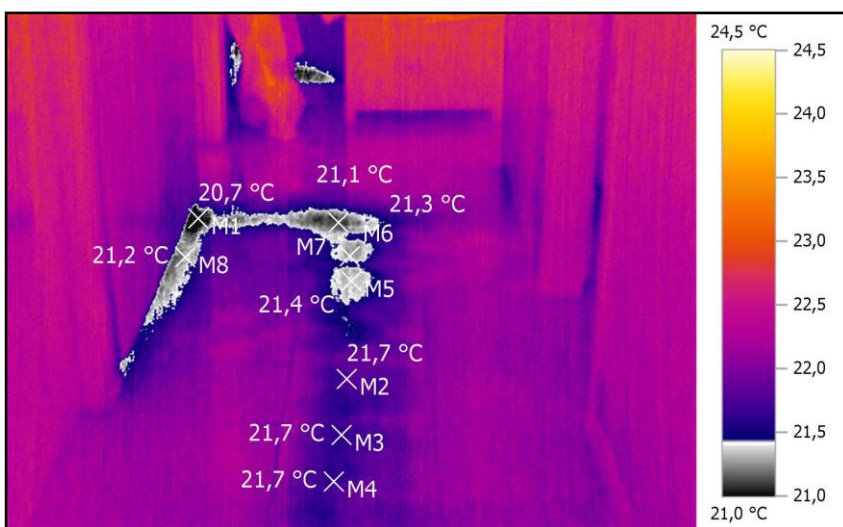
Immagine Termografica n. 1801 IR
